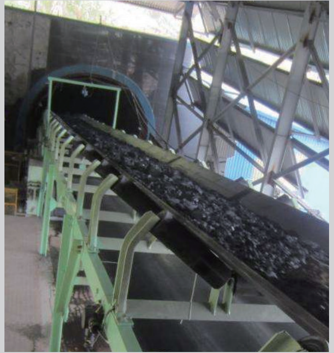
皮带机温度监控
